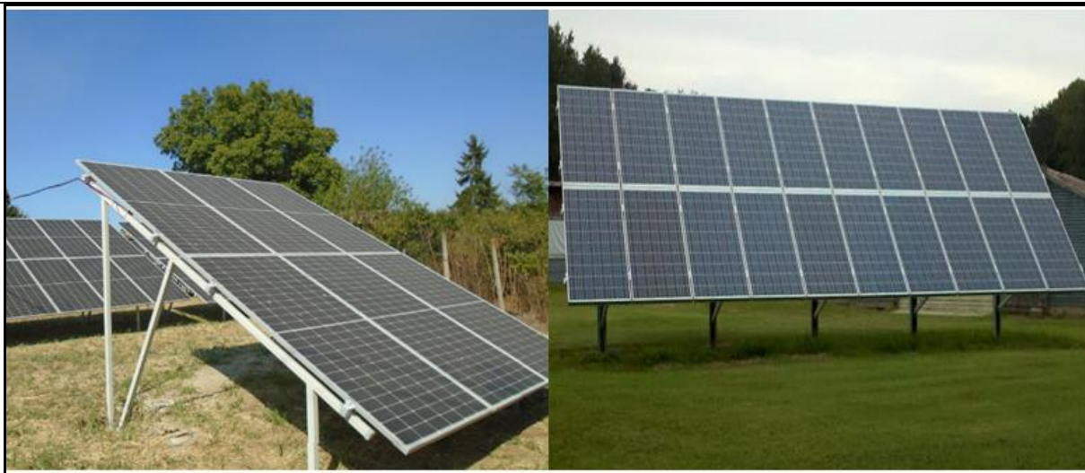
Фиг. 1.1-6. Разположение на фотоелектричните панели върху носещите конструкции
